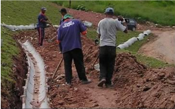
Captação de água da chuva
