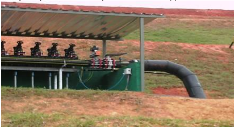
Captação e transporte de biogás
