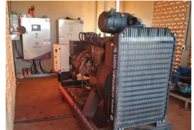
Grupo gerador a biogás, Toledo (PR).
